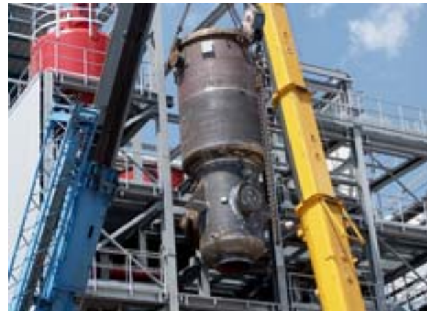
Installation Niedertemperaturvergaser (NTV) 2005 CHOREN Industries GmbH
